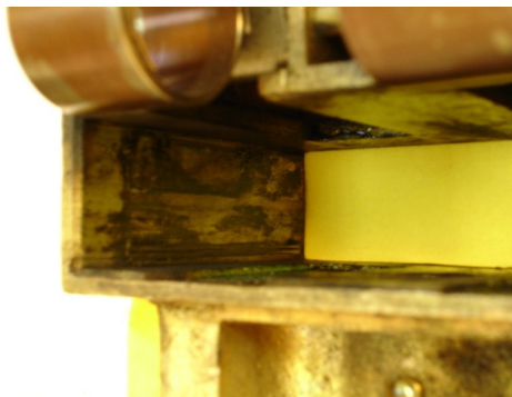
Rys. 8. Szczotki i trzymadło szczotkowe silnika trakcyjnego lokomotywy EP09 z naciekami substancji żywicznej powodującej zakleszczanie się szczotek [2]
